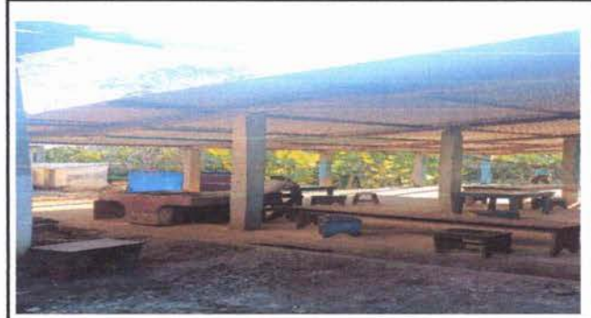
Foto 4: Cambio de pila por deterioro.
